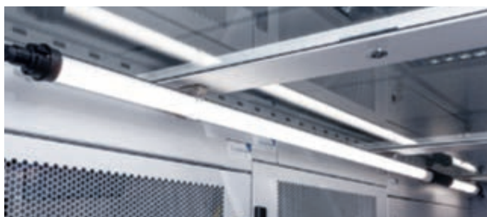
Éclairage à LED
