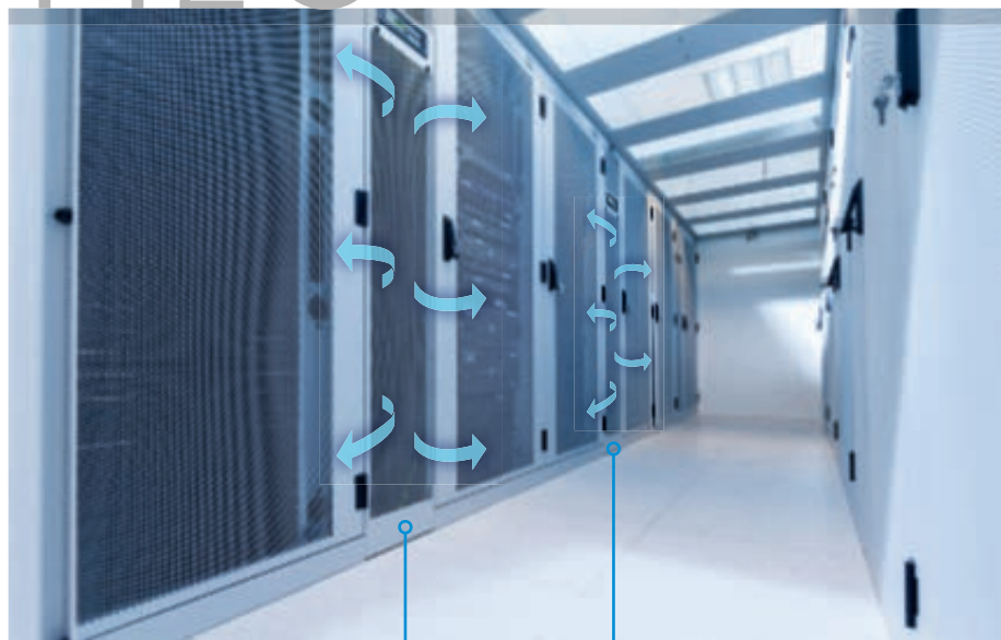
Exemple de système de refroidissement H 2 O dans une allée froide confinée
